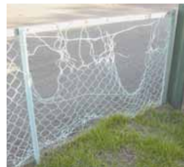
フェンス金網の落下状況
